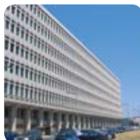
Reparação das Fachadas e Cobertura do Palácio da Justiça de Lisboa, Lisboa
